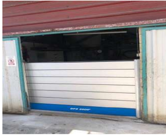
Entrada Compresores 2,3m x 1,4m de alto
