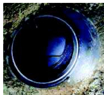
la salida de drenaje con válvula
