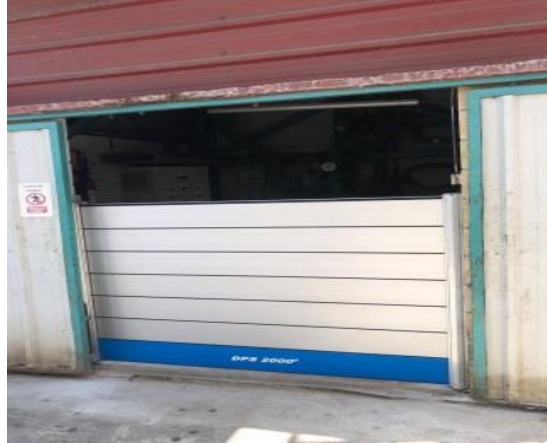
Entrada Compresores 2,3m x 1,4m de alto
